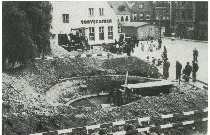
Bygning af beskyttelsesrum på Torvet - i baggrunden ses Kielbergs nødbutik efter at hans forretning schalburgteredes den 7. marts 1944.
